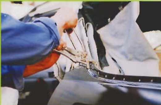
●アウターパネルの塗膜剥離
